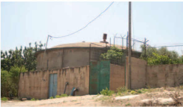
خزان مياه قديم بحاجة لاعادة تأهيل-قباطية
