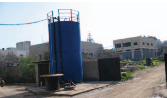
محطة تعزيز ضخ المياه في قباطية
