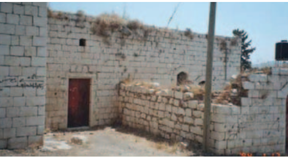
مباني تراثية بحاجة لترميم وسط الزبادة
